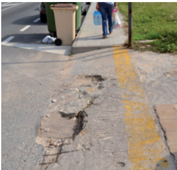
Parts de la vorera estrets o en mal estat.
