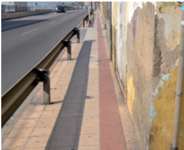
Tanca protectora més pròpia de carreteres interurbanes.
