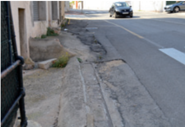
Zona de discontinuïtat i mal estat de la vorera en extrems del tram
