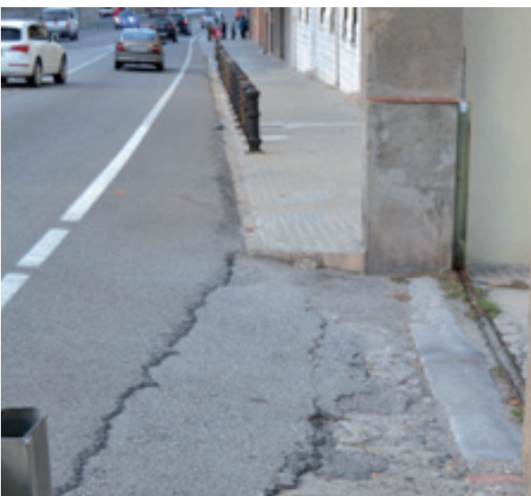
Mal estat de les voreres
