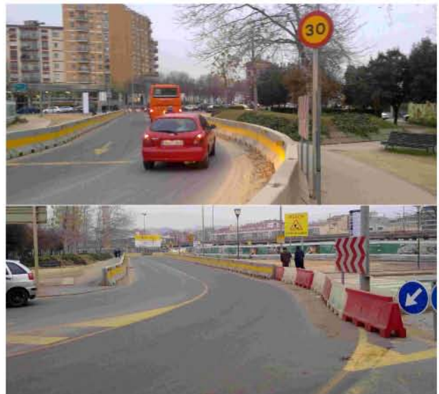
Exemples de l'estat de la pintura horitzontal
